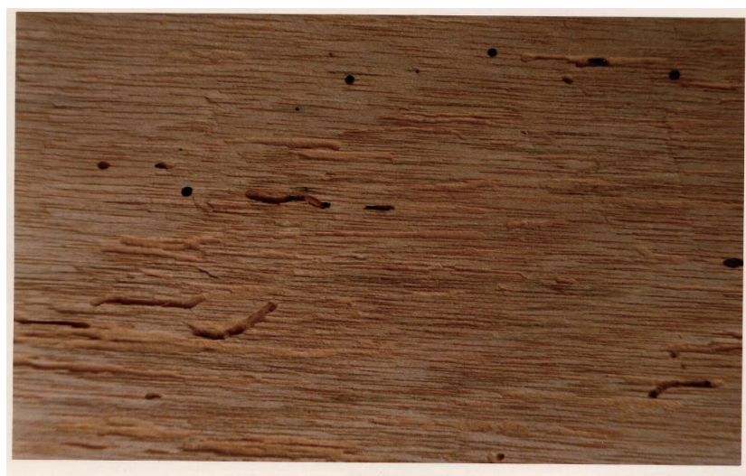
写真4 合板の被害；フローリングの裏側
