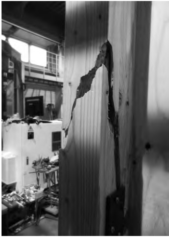
図2-8 柱の引張破壊
