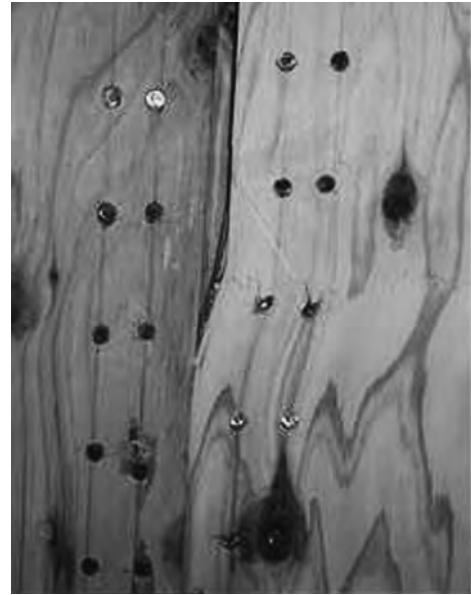
図3-6 合板のせん断破壊
