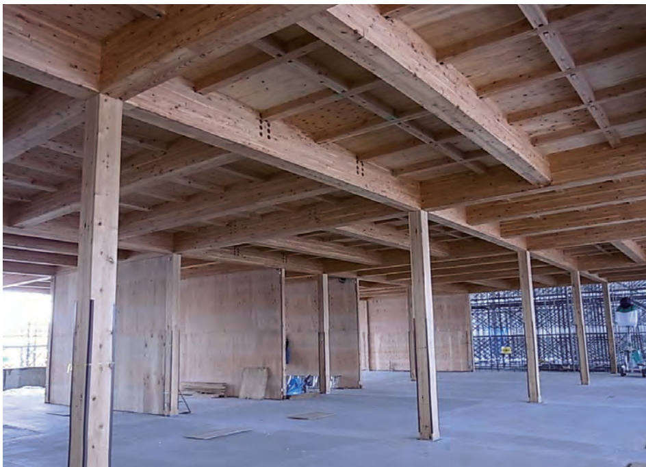
厚さ24mm構造用合板による耐力壁と床構面の施工現場
