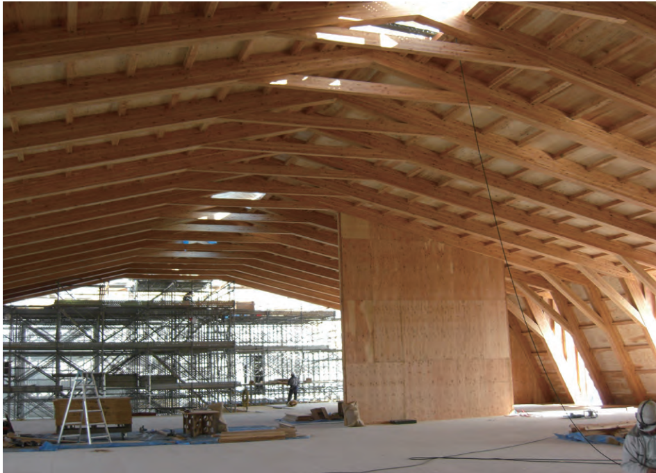
厚さ24mm構造用合板による耐力壁と屋根構面の施工現場
