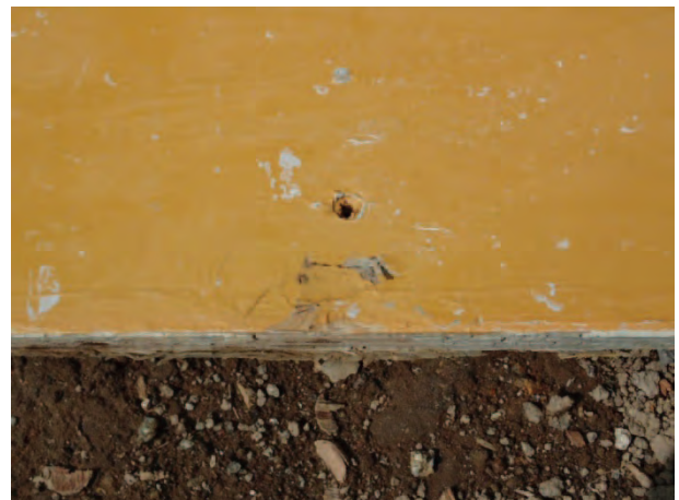
写真7．塗装面の状況（転用1回目） 塗装面の損傷もあまりみられない
