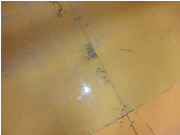
写真3. 塗装の剥がれ (仕上がりでは特に問題なし)
