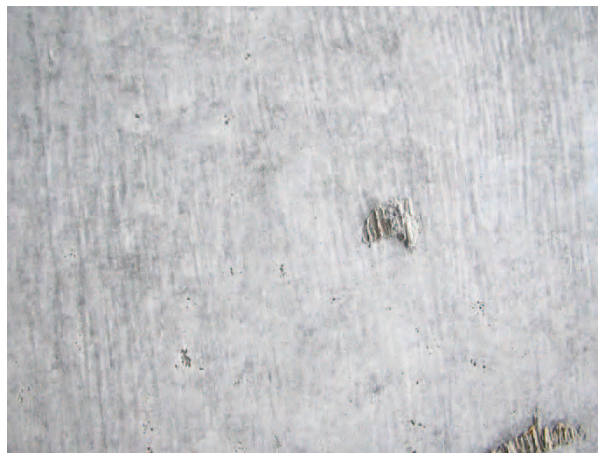
写真9. ラワン型枠のコンクリート表面（シワあり）
