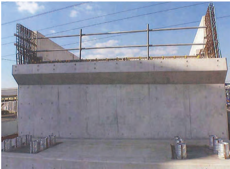
写真7．国産材型枠のコンクリート表面 特に問題なし
