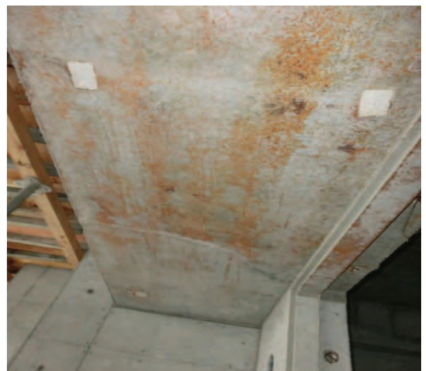
写真5．2階室内スラブ（ラワン型枠） 脱型後着色がみられる
