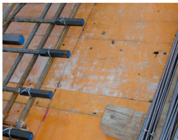
写真2．スラブ2回目（国産材型枠） 木目やシワのためコンクリートが白く残っている
