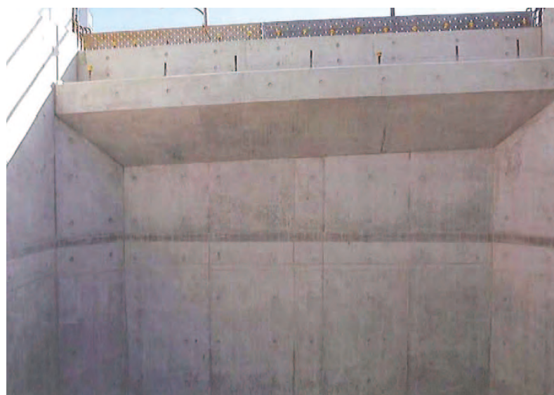
写真8．ラワン型枠のコンクリート表面 特に問題なし
