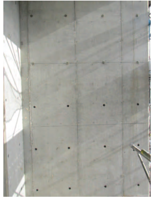
写真6. ラワン型枠使用のコンクリート表面
